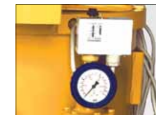
Grupo de controlo da pressão
