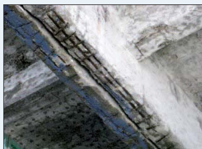
Figura 3 - Le travi con le armature arrugginite
