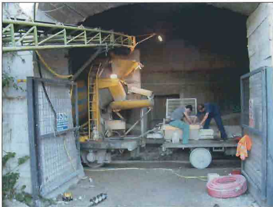
Le operazioni di carico del carro betoniera da un accesso laterale del tunnel ferroviario
