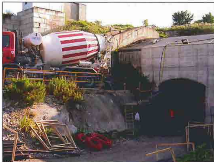
Il cemento e gli inerti arrivano in cantiere secchi trasportati dalla autobetoniera
