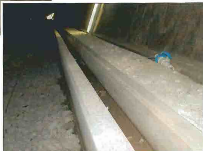
La canalina dopo lo scassero: buona qualità di getto per una lunga resistenza del manufatto
