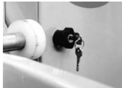
Lo sportello del quadro comandi è protetto da una robusta serratura che evita sabotaggi e manomissioni
