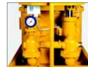
Grupo de bombeo
