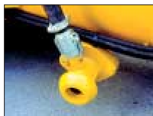
Sortie cuve avec raccord Perrot
